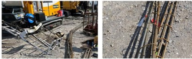
Beschadigde graafmachine en wapeningskorf Wapeningskorf met rondlopende ringen
